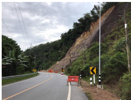
รูปที่ 6.4-6 จุดป้องกันการพังทลายหน้าดิน/ดินสไลด์ กม.134+30
